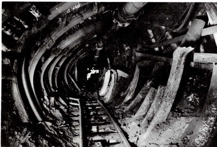
Abb. 41. Verformung einer streichenden Abbaustrecke mit Gleitring im Kohlenbergwerk Peißenberg. Die flözführenden Cyrenenschichten der gefalteten Molasse fallen mit 25° südwärts (im Bilde nach links) ein. Das Bild wurde im Jahre 1963 in 1120 m unter Tage, 200 m hinter der Abbaufront aufgenommen. Durch die abbaubedingte Spannungsumlagerung war ein nordwärtiger Überschiebungsprozeß ausgelöst worden. Die rezente Deformation entspricht dem Stil der jungen Tektonik am Rande der Faltenmolasse. – Mit freundlicher Genehmigung von Herrn Bergwerksdirektor a. D. HEISSBAUER. (Wörtlich aus: ILLIES & GREINER 1976, Abb. 7)
